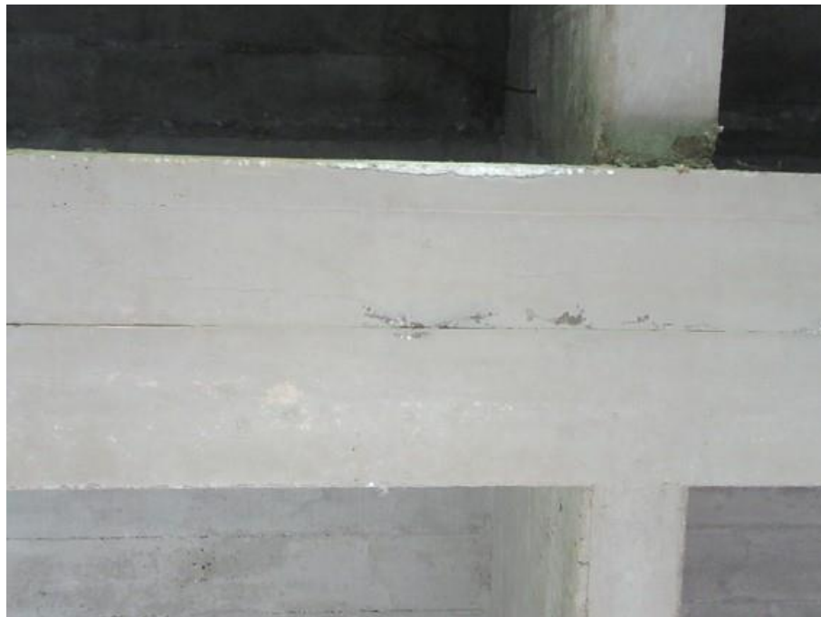
Foto 26 (IMG_1607): Viga longarina 2 – Fissura horizontal – Face inferior.
