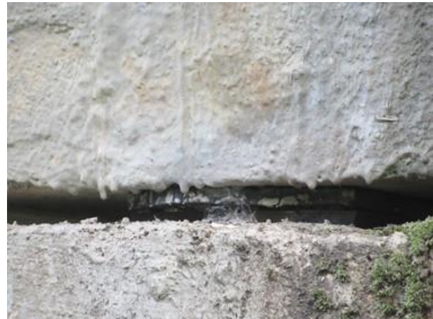
Foto 31: Aparelho de apoio comprometido - VL 8 - Encontro 2 - Apoio 3.
