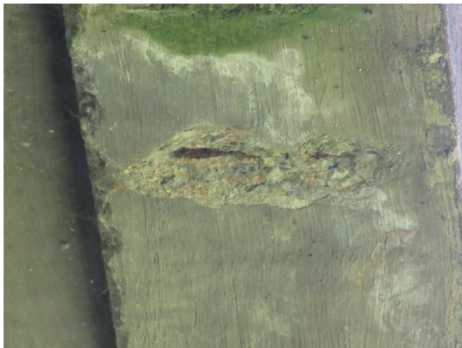
Foto 32 (IMG_1740): Balanço Oeste – Armadura exposta.
