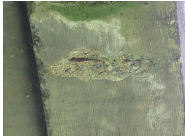
Foto 10: Balanço Oeste – Vista Norte/Sul – Armadura exposta oxidada.
