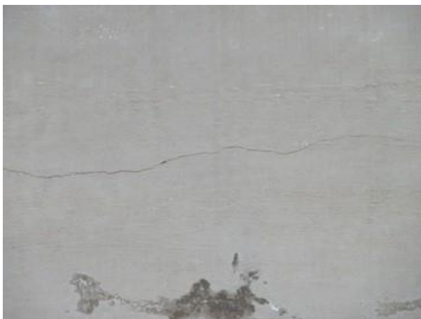
Foto 17: Viga Longarina 2 – Fissura horizontal – face inferior.
