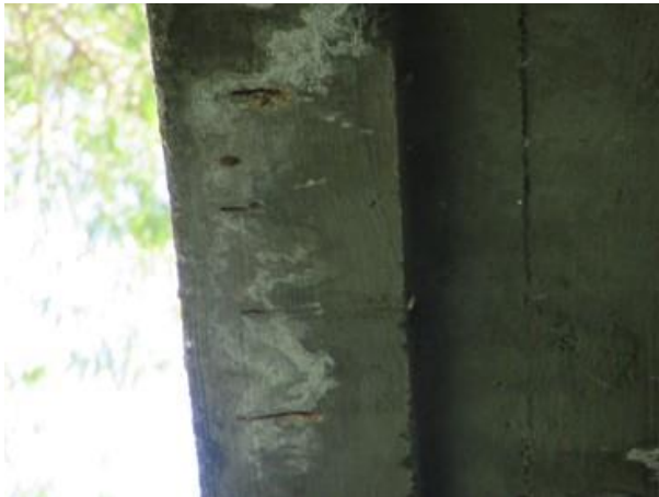
Foto 11: Balanço Oeste – Vista Norte/Sul – Armadura exposta oxidada.
