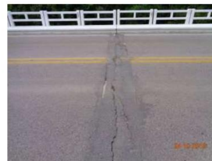
Foto 8. Junta de dilatação recoberta por capa asfáltica com sinais de ruptura.
