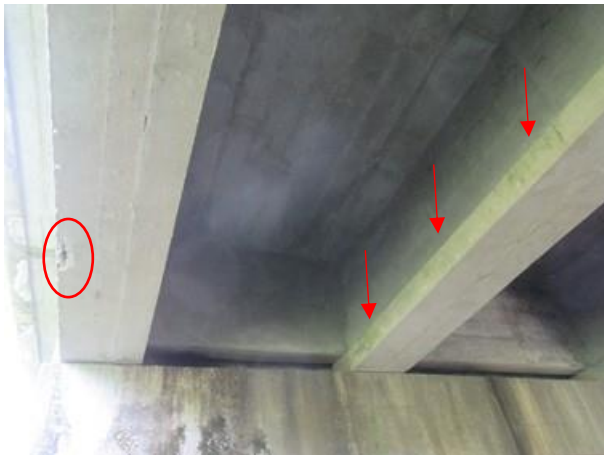
Foto 21: VL 4 e VL3 - Manchas de umidade e concreto desagregado com armadura exposta.
