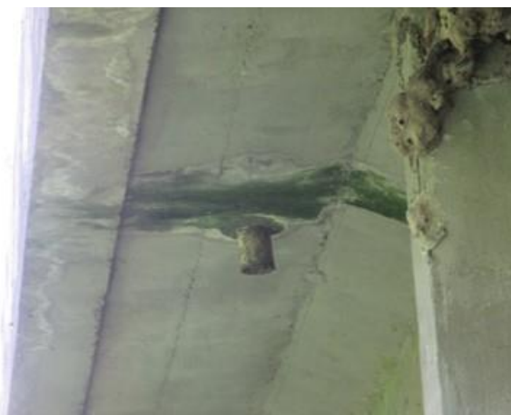
Foto 68: Balanço Oeste – Mancha de Infiltração.
