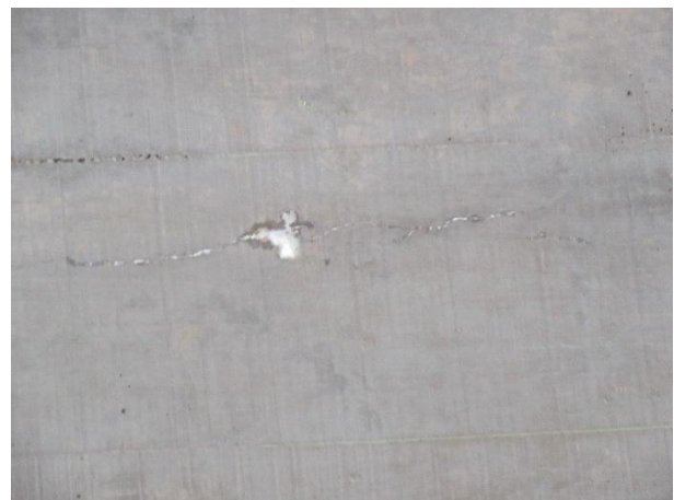
Foto 24: Viga Longarina 2 - Fissura com eflorescência – Face inferior.
