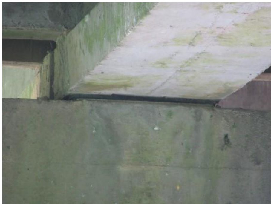
Foto 58 (IMG_1827) Aparelho de apoio danificado – VL 7 Apoio 2.
