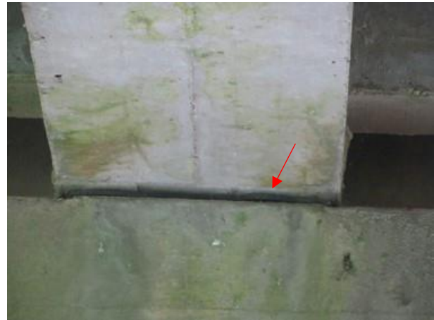
Foto 33: Aparelho de apoio apresentando fissuras e deformações excessivas.
