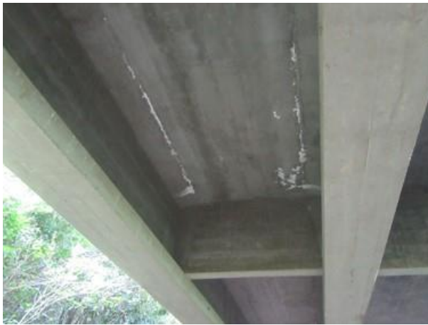
Foto 15: Tabuleiro 1 - Fissuras com eflorescência e formação de estalactites.
