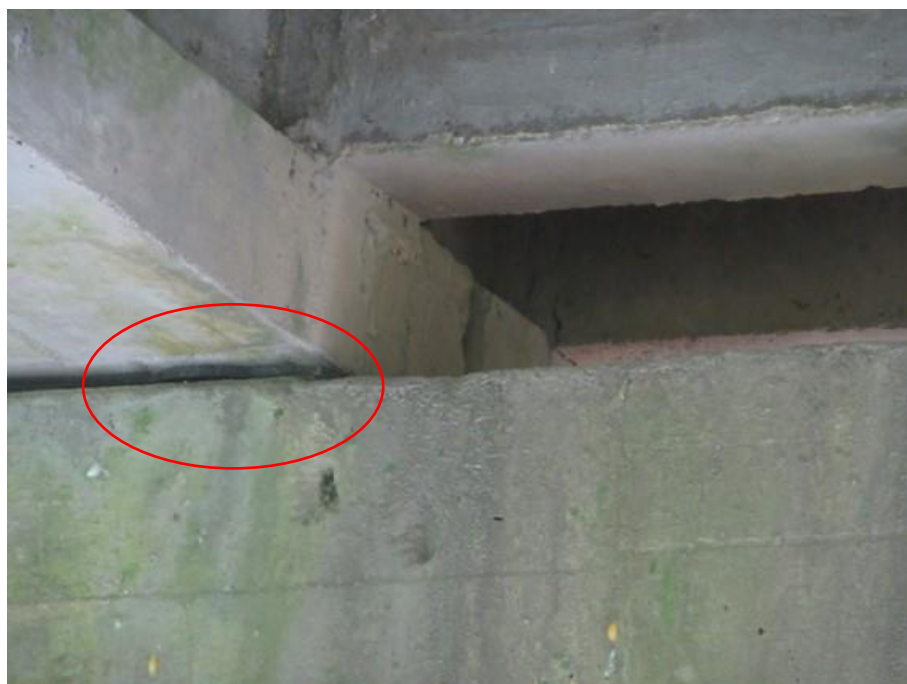
Foto 60 (IMG_1842) Aparelho de apoio danificado – VL8 Apoio 2.
