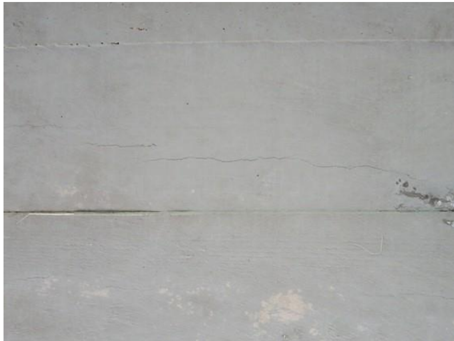
Foto 25 (IMG1608): Viga longarina 2 – Fissura horizontal – Face inferior.
