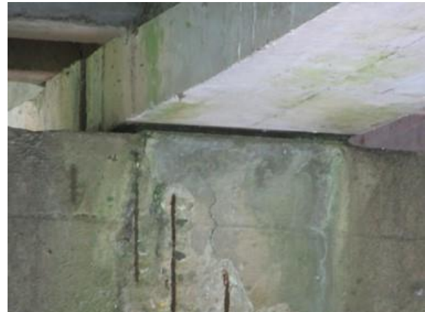
Foto 43: Aparelho de apoio - VL6 - Apoio 2 - Viga travessa com armadura exposta e oxidada.
