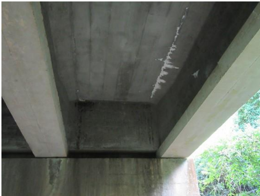
Foto 18 (IMG_1542): Laje – Face inferior entre VL1/VL2 e entre VT1 e VT2 – Vista Sul/Norte.
