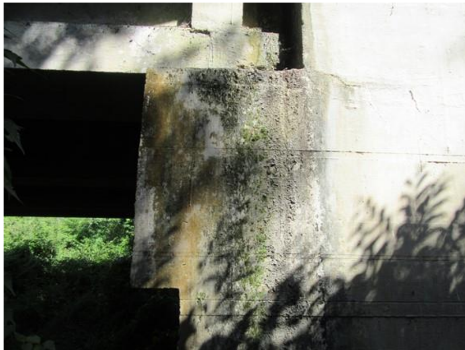
Foto 64 (IMG_1500) Apoio Longarina 1 – Encontro 1 – Face Leste – Infiltração pela junta 1.
