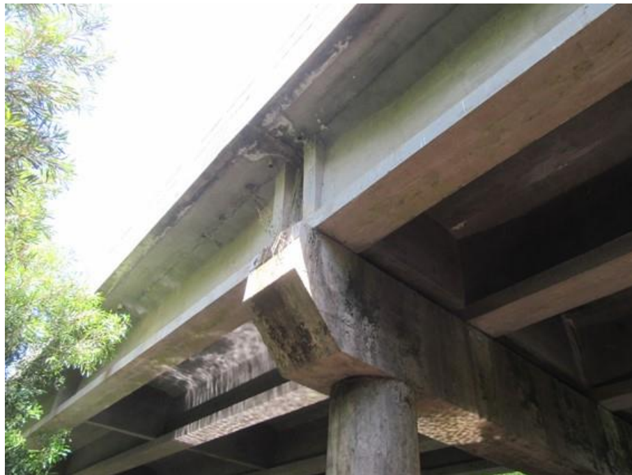
Foto 66 (IMG_1640) Apoio 2 – Viga Longarina 1 e 5 – Face Leste – Infiltração pela junta 2.
