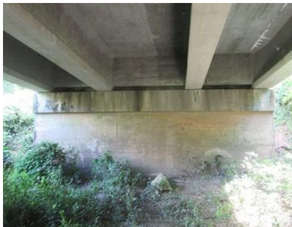
Foto 36: Cortina - Encontro 1 - Mancha de umidade e eflorescência.
