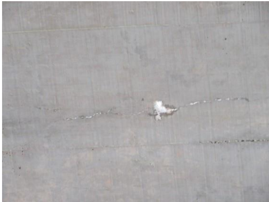
Foto 27 (IMG_1617): Viga longarina 2 – Fissura horizontal – Face inferior.
