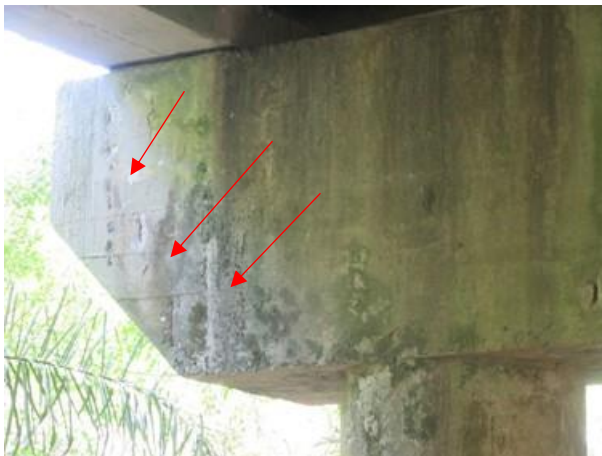
Foto 44: Apoio 2 - Viga travessa face sul - Concreto desagregado e Cobrimento insuficiente.
