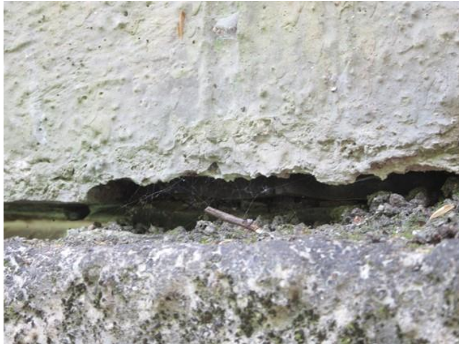
Foto 49 (IMG_1661) Aparelho de apoio comprometido – VL1 – Apoio 1.
