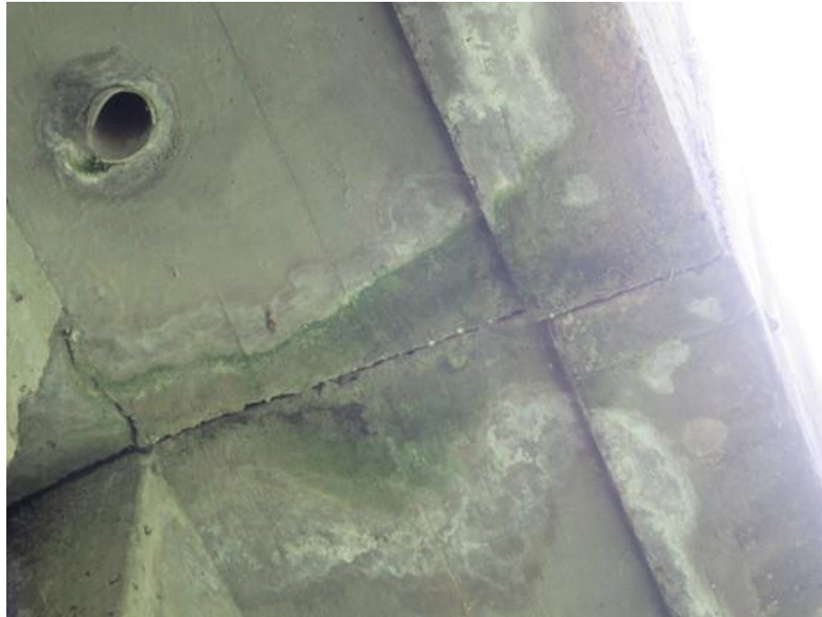
Foto 31 (IMG_1738): Balanço Leste – Infiltração na junta de dilatação 2.
