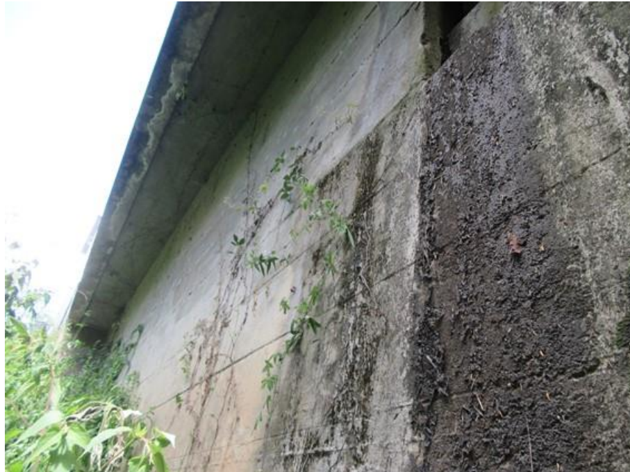
Foto 61 (IMG_1746) Muro de ala leste – Encontro 2 (Sul) – Infiltração pela junta 3.
