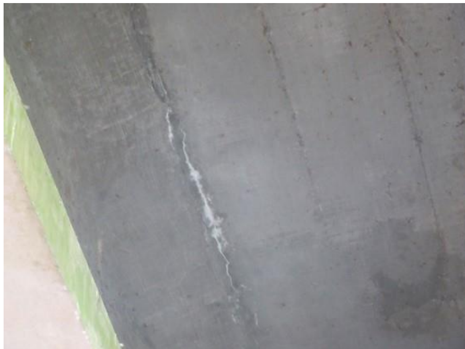
Foto 24 (IMG_1598): Laje – Face inferior entre VL3/VL4 e entre VT3 e VT4.
