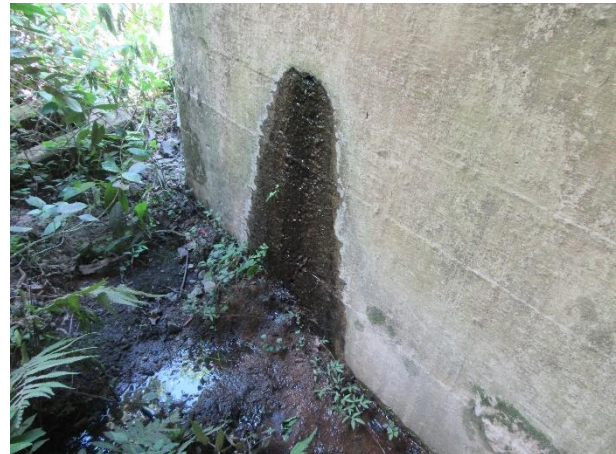
Foto 39: Cortina - Encontro 2 – Manchas de umidade e eflorescência.
