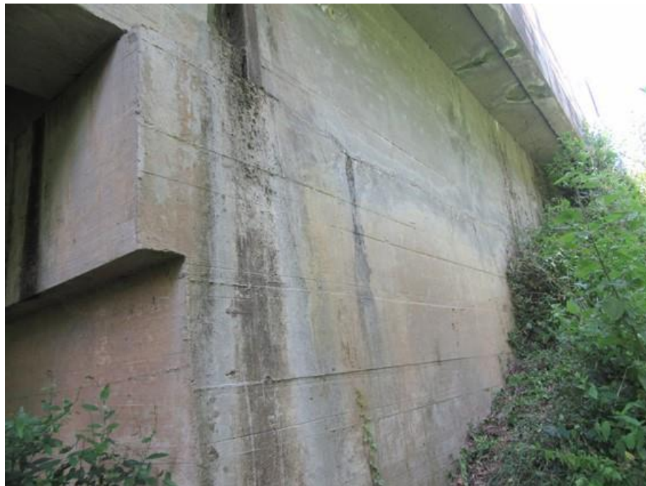
Foto 62 (IMG_1732) Muro de ala Oeste – Encontro 2 (Sul) – Infiltração pela junta 3.
