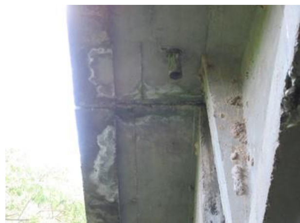
Foto 14: Balanço Oeste – Infiltração pela junta de elástica.
