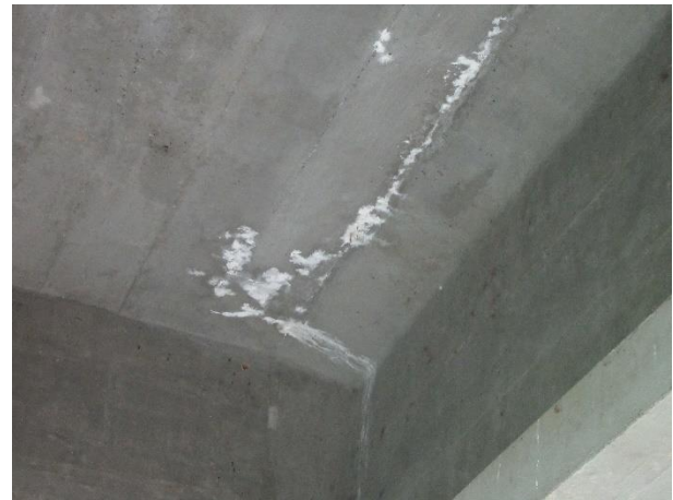
Foto 16: Tabuleiro 1 - Fissuras com eflorescência e formação de estalactites
