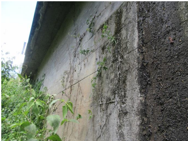
Foto 40: Encontro 2 - Muro de ala Leste - Manchas de umidade e eflorescência.
