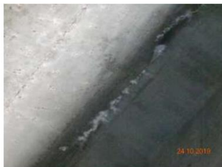
Foto 5. Fissura com eflorescência na ligação viga longitudinal / laje.
