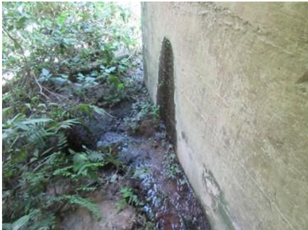
Foto 38: Cortina - Encontro 2 - Infiltração.
