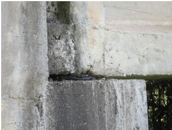
Foto 26: Encontro 1 – Aparelho de apoio VL4 - Comprometido.
