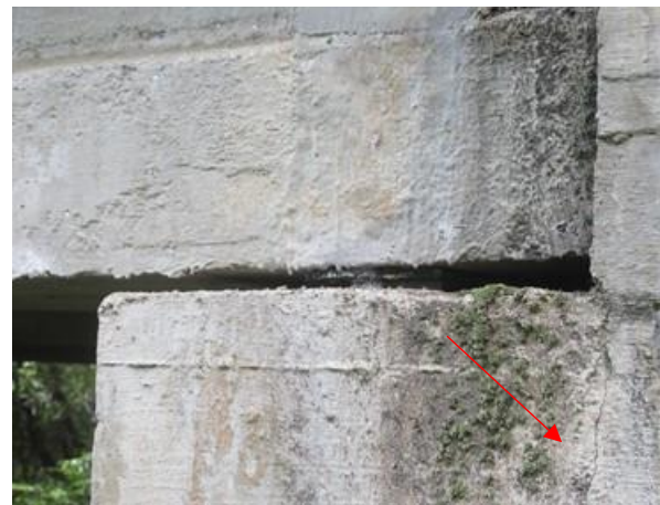
Foto 37: Aparelho da VL 8 - Encontro 2 - Apoio 3 – Fissura vertical no consolo da cortina 2.
