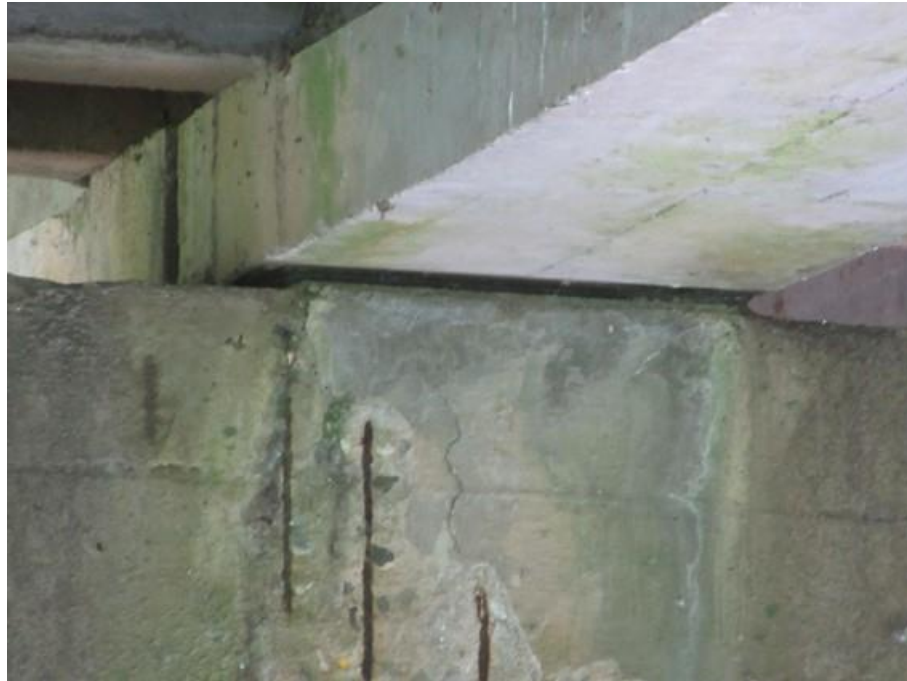
Foto 57 (IMG_1822) Aparelho de apoio danificado – VL6 Apoio 2.
