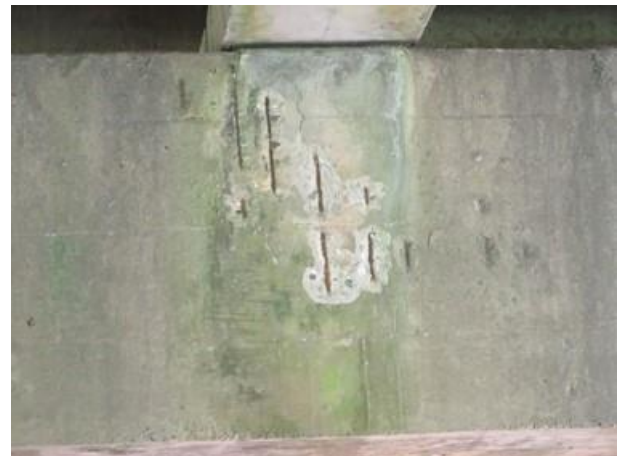
Foto 45: Apoio 2 - Viga travessa face sul - Armadura exposta oxidada.
