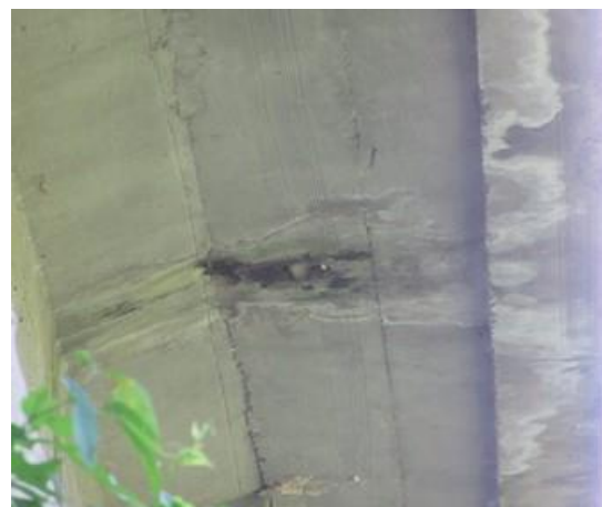
Foto 69: Balanço Oeste – Manchas de umidade e eflorescência.
