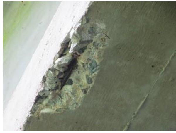
Foto 22: Viga Longarina 4 – Armadura exposta e oxidada.
