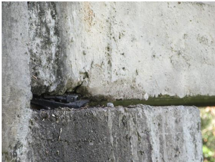
Foto 52 (IMG_1680) Aparelho de apoio comprometido – VL4 - Apoio 1.
