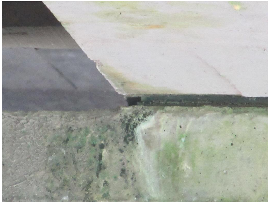
Foto 51 (IMG_1703) Aparelho de apoio danificado – VL3 Apoio 2.
