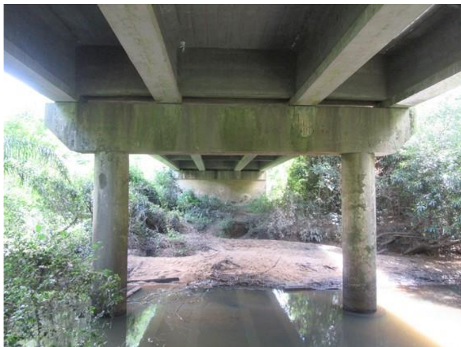
Foto 46 (IMG_1760) Apoio 2 – face sul – Armadura exposta e oxidada.
