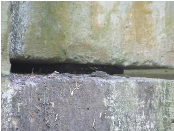
Foto 32: Aparelho de apoio – VL5 – Apoio 3 – Fissuras e deslizamento entre perfis.
