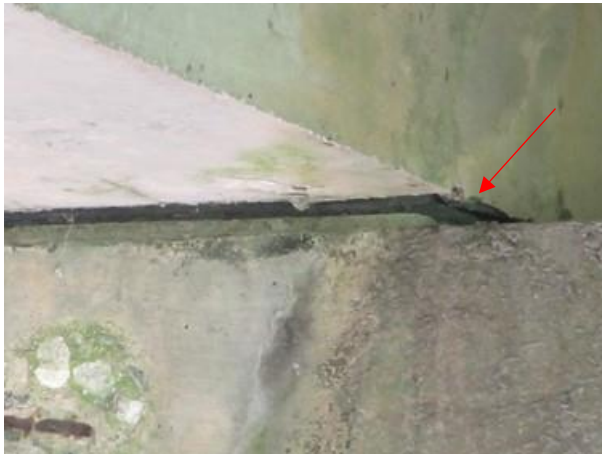
Foto 30: Aparelho de apoio – VL2 – Apoio 2 – face norte – Deslizamento entre perfis.
