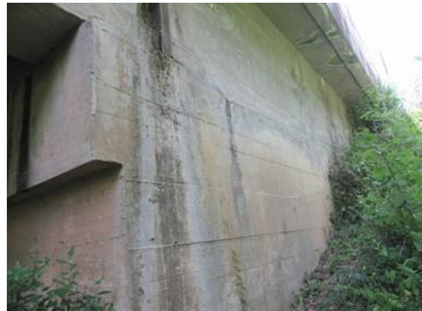
Foto 41: Encontro 2 - Muro de ala Oeste - Manchas de umidade e eflorescência.
