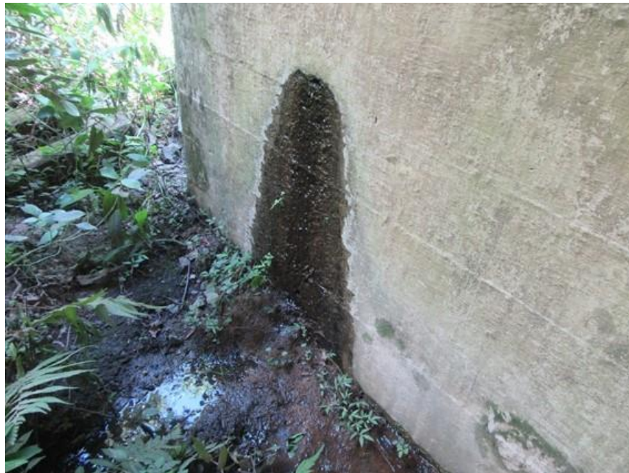
Foto 63 (IMG_1884) Encontro 2 – Cortina - Infiltração.
