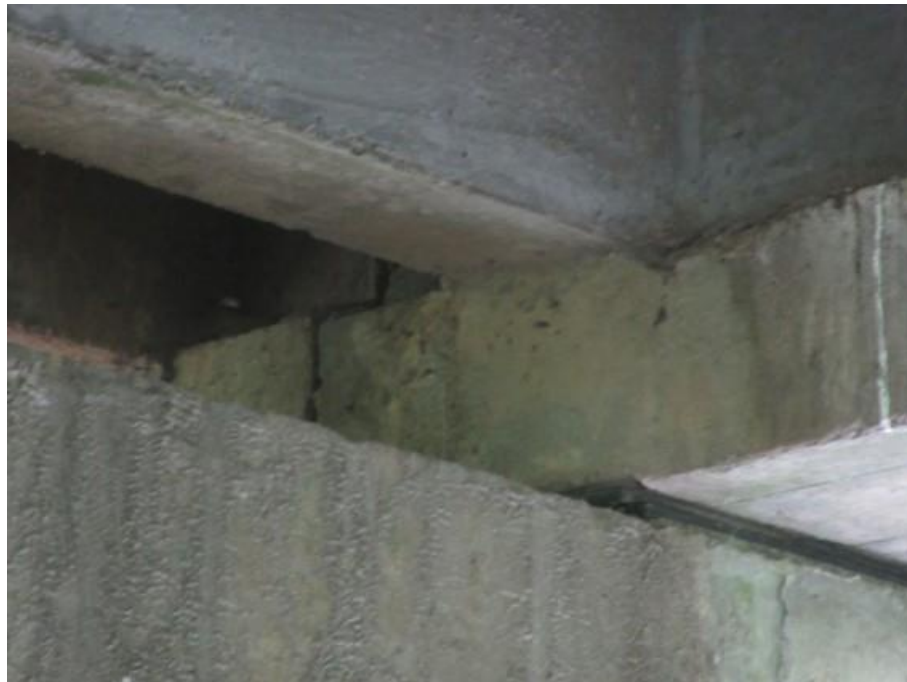
Foto 59 (IMG_1835) Aparelho de apoio danificado – VL5 Apoio 2.
