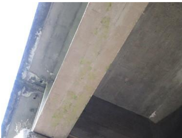
Foto 23: VL1 - Face inferior - Mancha de umidade.
