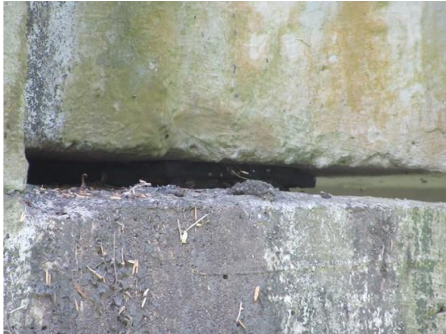
Foto 55 (IMG_1793) Aparelho de apoio danificado – VL 5 - Apoio 3.
