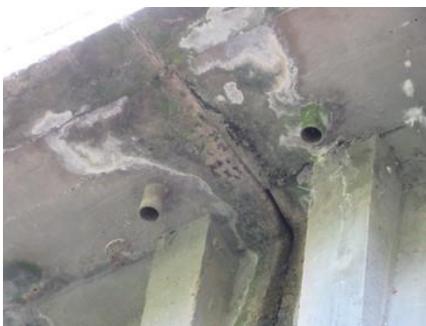
Foto 13: Balanço Oeste – Apoio 2 – Infiltração na Junta entre vigas longarinas.
