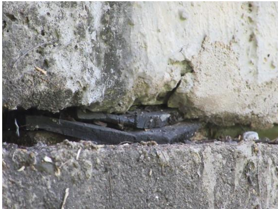
Foto 53 (IMG_1682) Aparelho de apoio comprometido – VL4 - Apoio 1.
