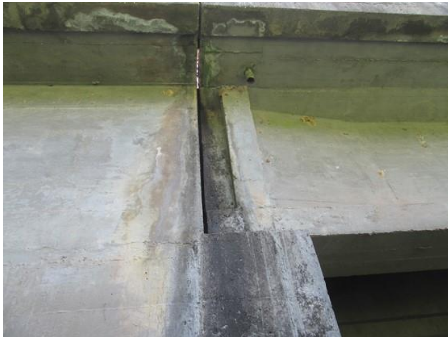
Foto 65 (IMG_1531) Apoio Viga longarina 4 – Encontro 1 – Vista Oeste – Infiltração pela junta 1.
