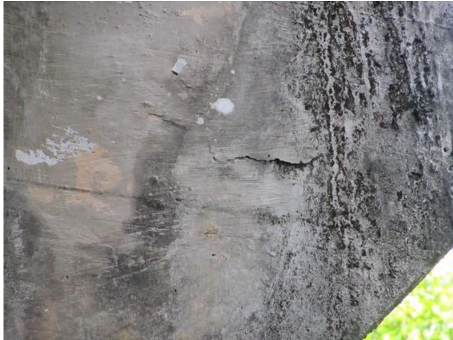
Foto 47 (IMG_1657) Viga travessa – Concreto desagregado.
