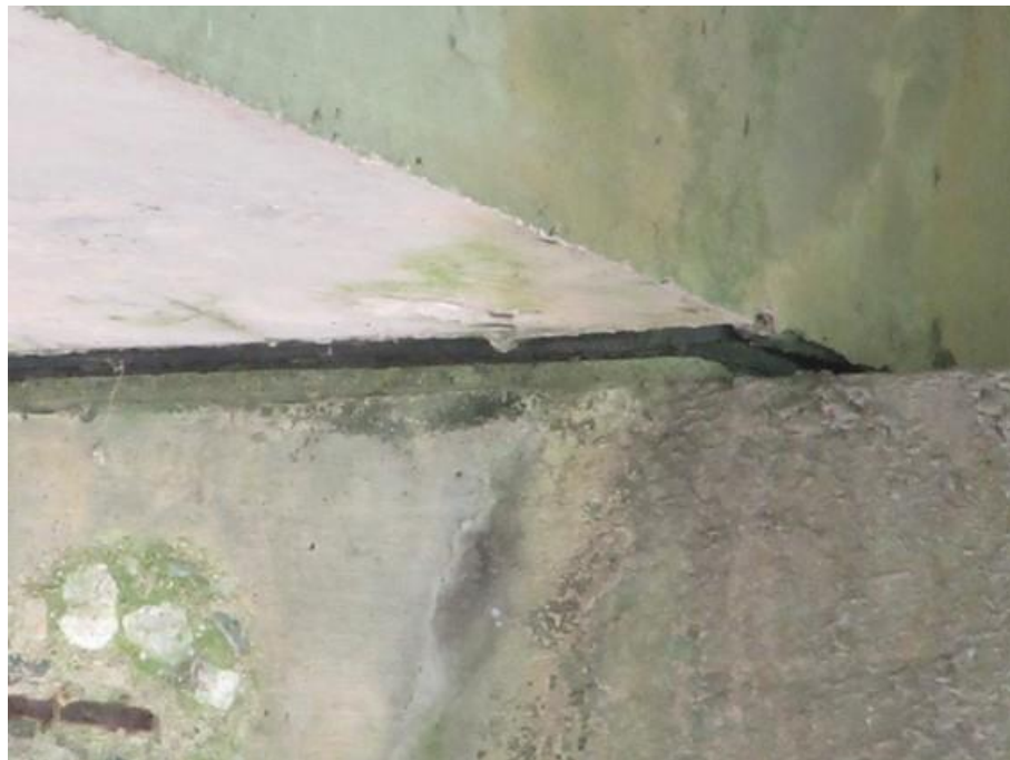
Foto 50 (IMG_1699) Aparelho de apoio danificado – VL2 Apoio 2.
