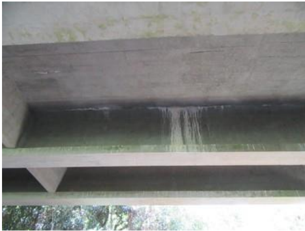
Foto 19: Viga longarina 3 - Eflorescência.
