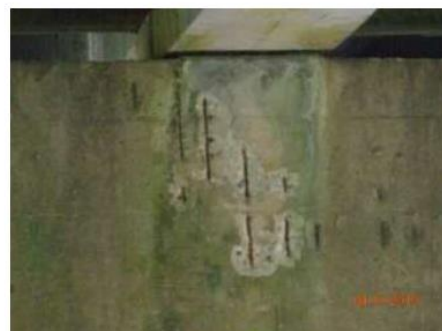
Foto 7. Concreto disgregado com armadura exposta e corroida na travessa do Apoio.
