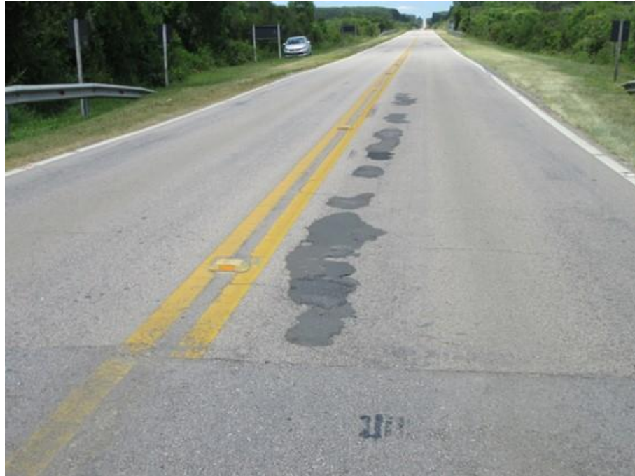
Foto 69 (IMG_1874) Aproximação sul – Reparos no pavimento.
