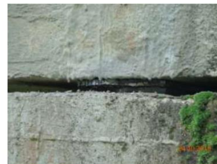
Foto 6. Aparelho de apoio em neoprene, deteriorado.
