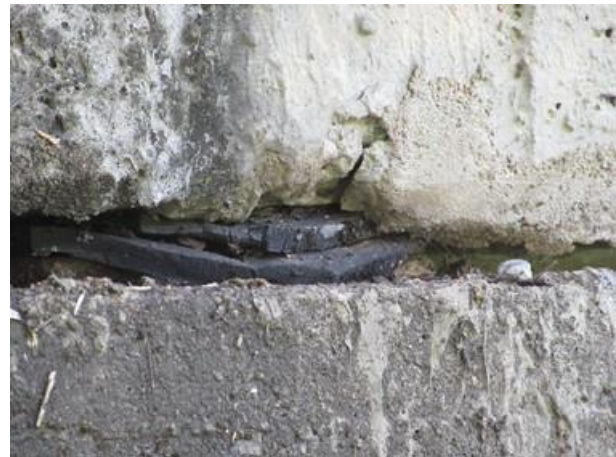
Foto 27: Detalhe: Encontro 1 – Aparelho de apoio VL4 - Comprometido.
