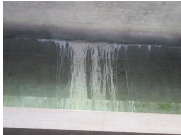
Foto 20: Viga longarina 3 - Eflorescência.
