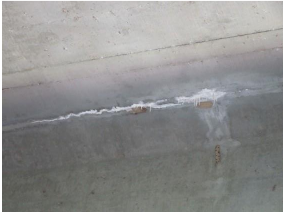
Foto 21 (IMG_1579): Laje – Face inferior entre VL2/VL3 e entre VT3 e VT4.
