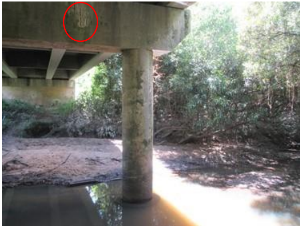
Foto 42: Apoio 2 - face sul - Viga travessa com armadura exposta oxidada e pilar 2 leste.
