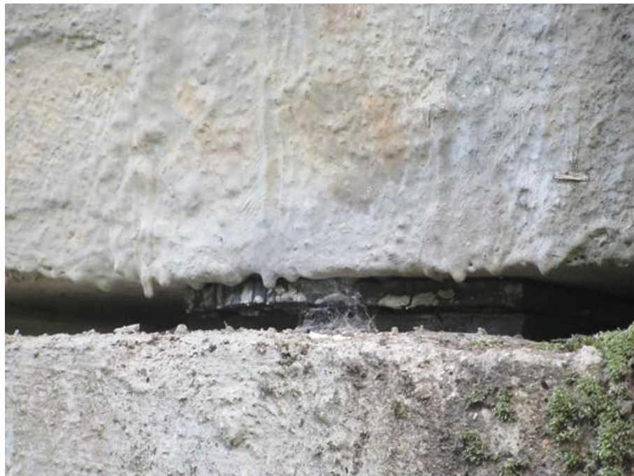
Foto 56 (IMG_1812) Aparelho de apoio comprometido – VL8 – Apoio 3.
