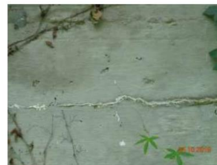
Foto 4. Fissura com eflorescência no muro de ala.
