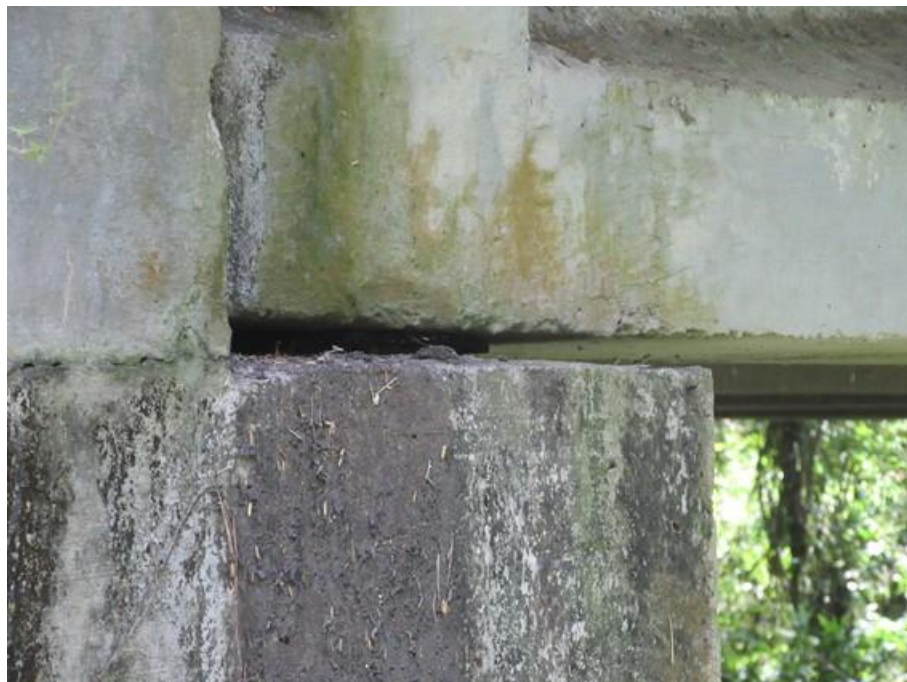
Foto 54 (IMG_1792) Aparelho de apoio danificado – VL 5 - Apoio 3.
